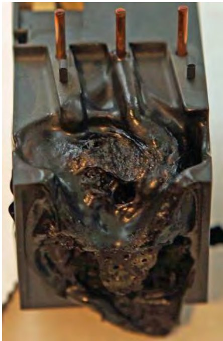
Kuva 33. Vaurioitunut kontaktori (© Jorma Korkalo, Primatest Oy).
